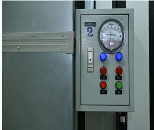
รูปที่ 3 มาโนมิเตอร์ตรวจวัดความดันภายในห้องตรวจ
